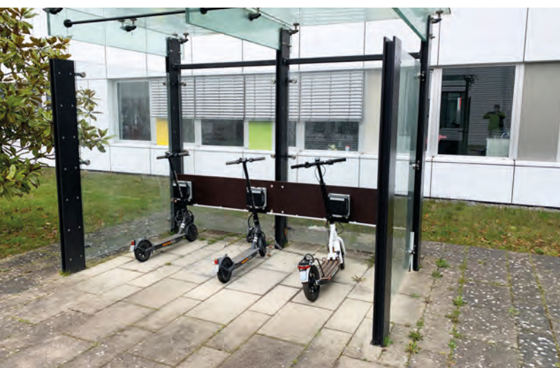
E-Roller für ZVO-Mitarbeiter*innen mit Ladestation vor der Zentrale in Sierksdorf
