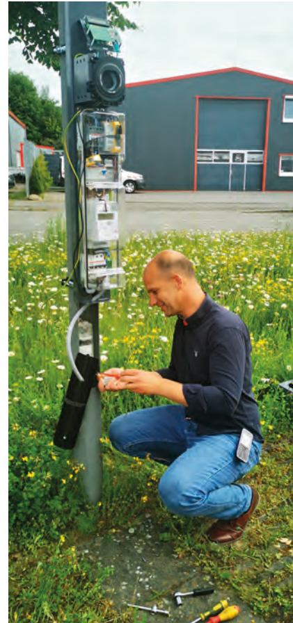
E-Ladesäule an einer Straßenlaterne
